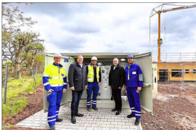
Vor Ort schauten sich (v. l.) OIE Vorstand Thomas Johann, Oberbürgermeister Frank Frühauf, Jan Knebel, Netzplaner bei Westnetz, Bürgermeister Friedrich Marx und Florian Schmidt, Leiter der Kommunalen Betreuung OIE, die neu errichtete Ortsnetzstation an. Foto: OIE
